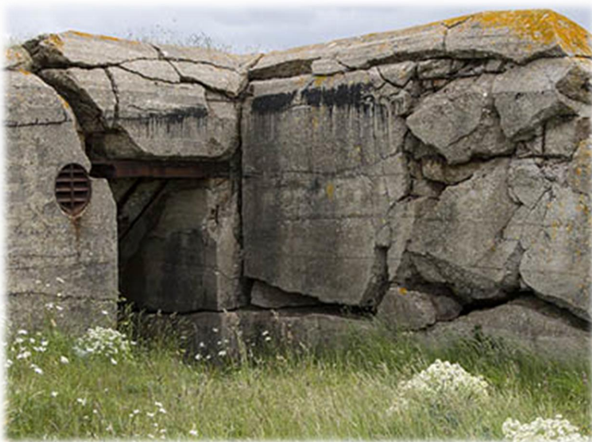
Batterie de Caqueret is een complex van bunkers die na de oorlog werden opgeblazen.
